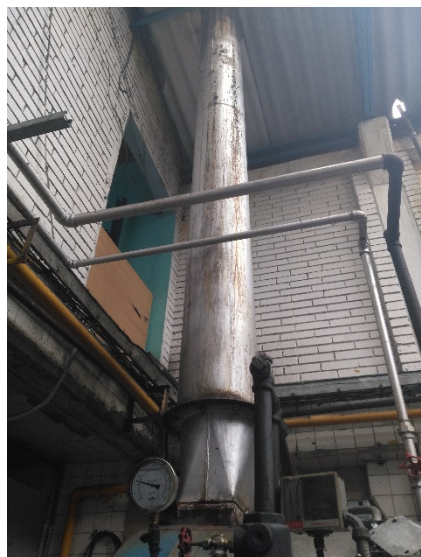
FOTO 3. DUCTO DE LA CALDERA 60 BHP
